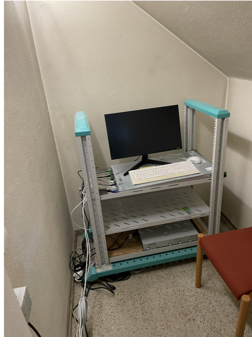
Der Server und der EDV Arbeitsplatz sind Provisorien. Eine komplette neue Installation EDV und Elektro ist notwendig.
