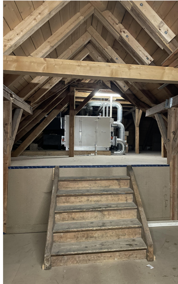
fehlende Brandwand zur Schule!
