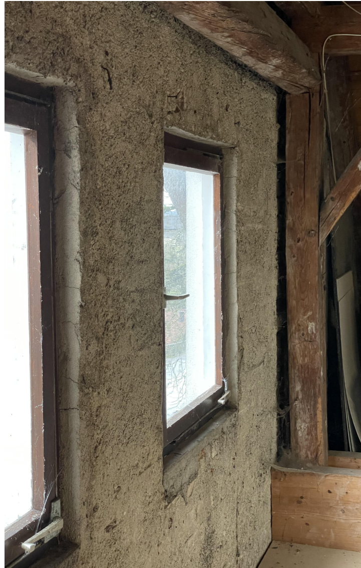
Unzureichend dünne Giebelwand
