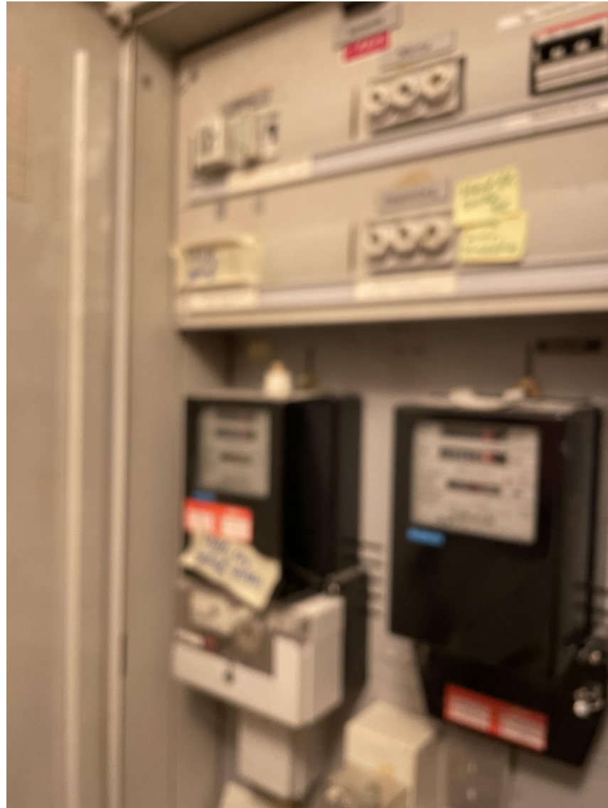
Elektrische Sicherung und vermutlich Verkabelung entsprechen nicht einer modernen Verwaltung.
