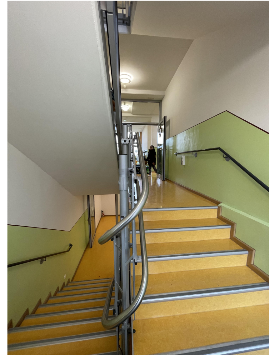
Barrierefreiheit in der Schule über nachträglich eingebauten Treppenlift.
