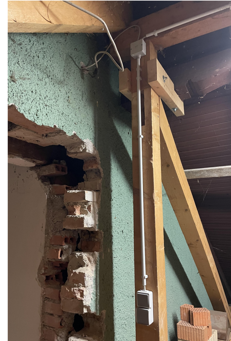
Der Dachausbau wurde nie abgeschlossen, dadurch sind statische Mängel, Brandschutzmängel und funktionale Mängel entstanden.
